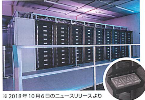
(2) 再利用した蓄電池148個のラック
